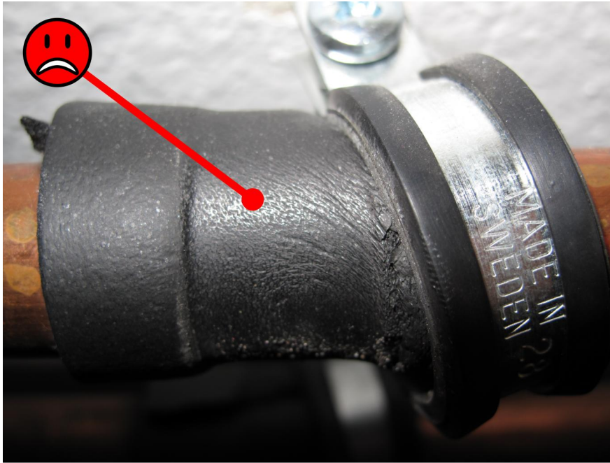
BILD 8. Värmerör med söndertryckt cellgummiisolerings under svepet. Vibrationsisolerande material ska tåla vibrationer, värme och tryck under lång tid, med garanti från leverantören.
